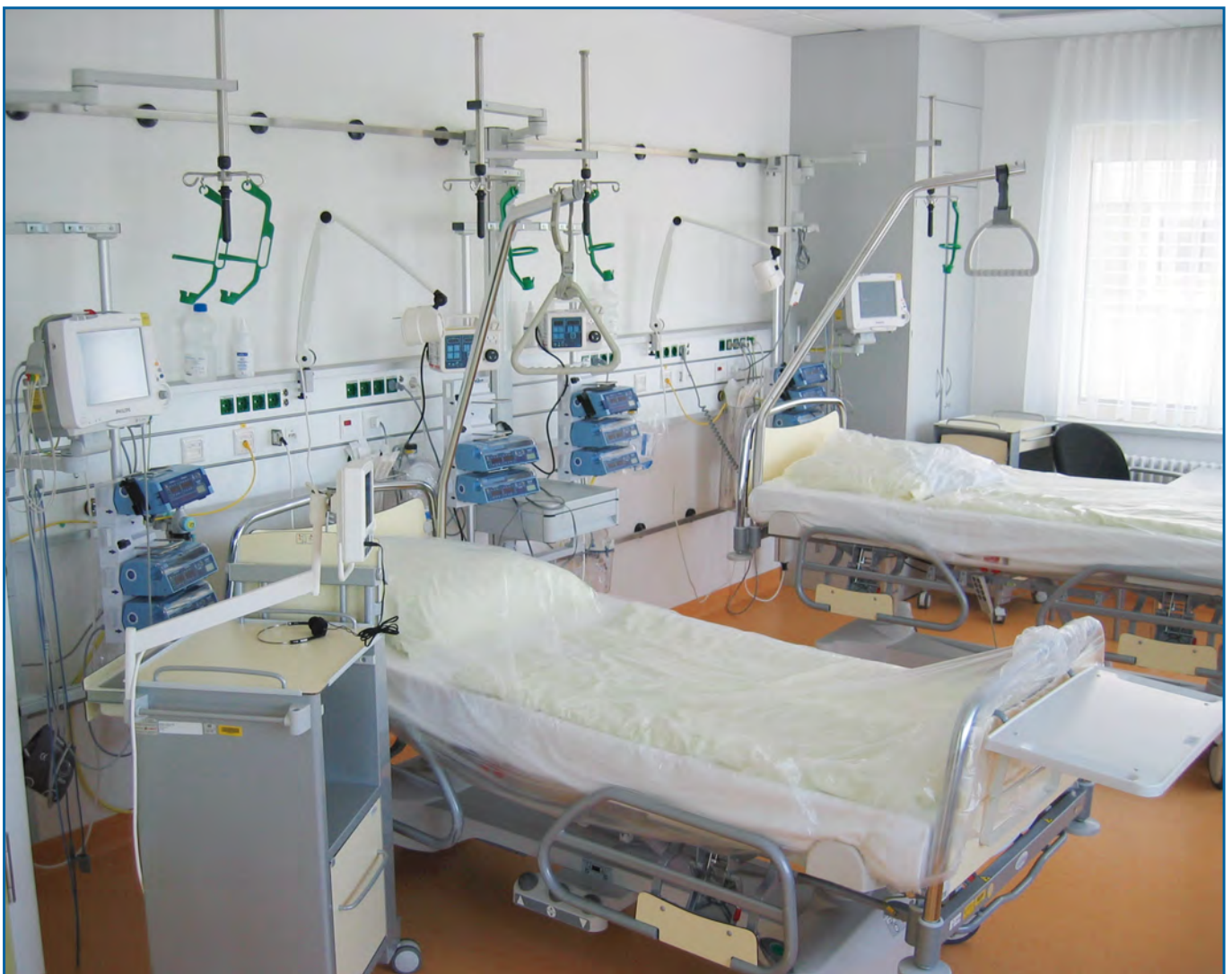
Befestigung an Wandversorgungskanal und Normschiene auf der Intensivstation
